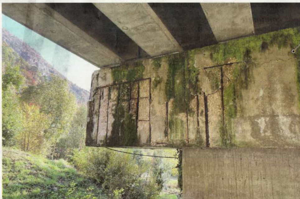
Uno scatto dal basso del viadotto a rischio sicurezza: è sos Nuovi appelli
